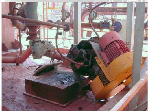
شکل 4-21. انفجار یک پمپ بر اثر فشار آب
